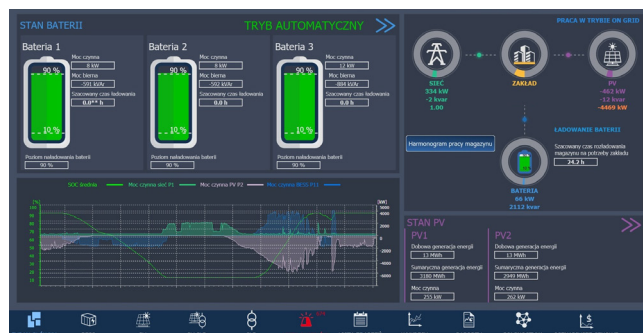
Zrzut z pulpitu operatora systemu EMS pokazujący stan pracy magazynu i farmy PV.
