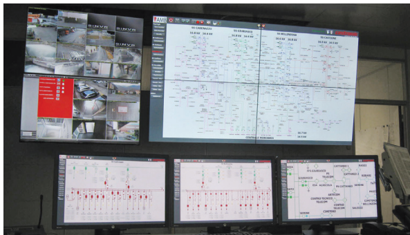
Abbildung 1: In der Leitwarte haben die Mitarbeiter immer Überblick über das komplette Netz und können jederzeit bis in die Details zoomen.
