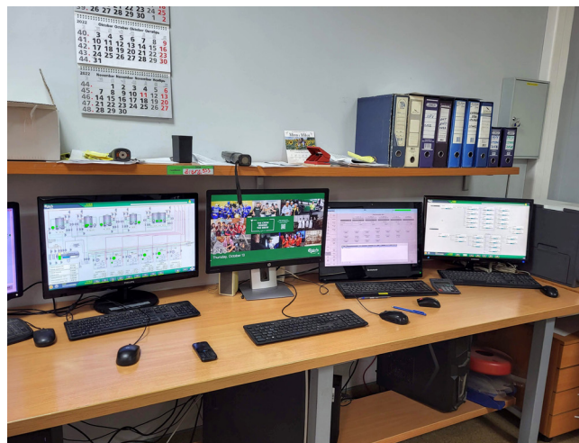
Zarządzanie energią i systemy chłodzenia.
