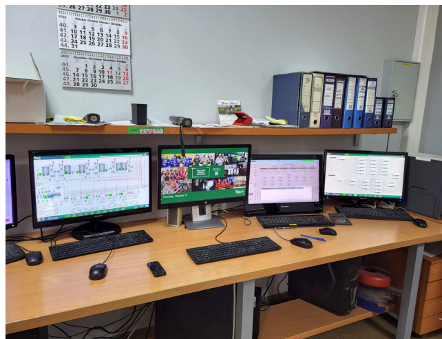
Sistemas de gerenciamento de energia e resfriamento.
