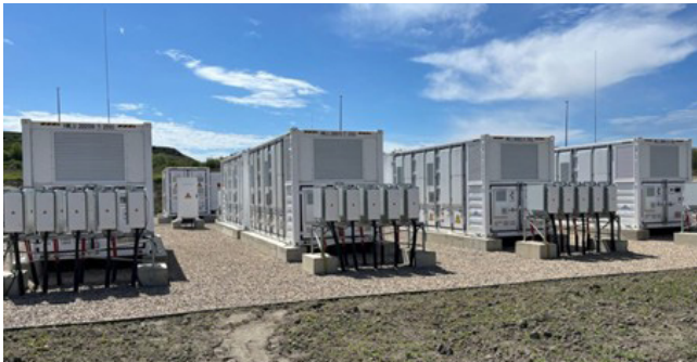
La struttura a container del sistema di accumulo di energia in batteria da 14 MWh: situata nell'area dello stabilimento Elemental a Zawiercie, ha una potenza di 7 MW.
