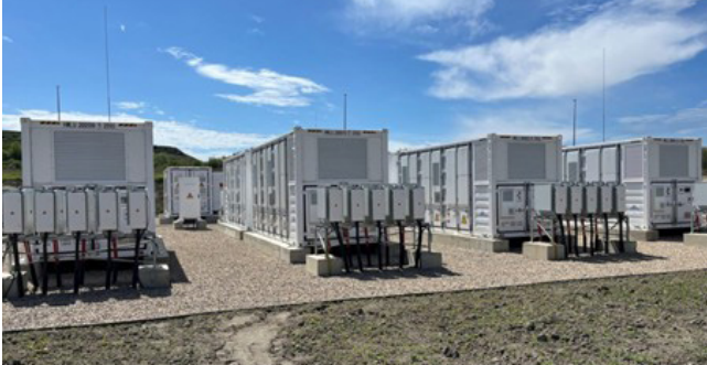
Containerisierter Aufbau des 14-MWh-Energiespeichersystems: Es befindet sich auf dem Gelände des Zawiercie-Werks von Elemental Strategic Metals und hat eine Leistung von 7 MW.
