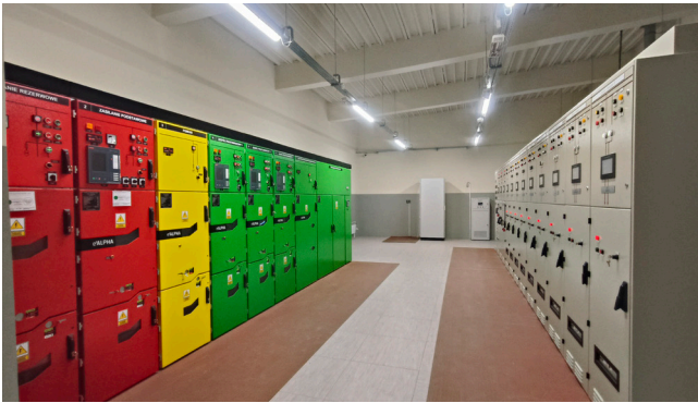
Mittelspannungs- und Gleichstromschaltanlagen in einem Straßenbahn-Unterwerk.
