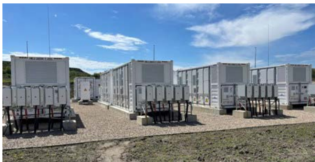
Zdjęcie kontenerowej zabudowy Baterijnego Magazynu Energii o pojemności 14MWh i mocy 7MW zlokalizowanego na terenie fabryki Elemental w Zawierciu.
