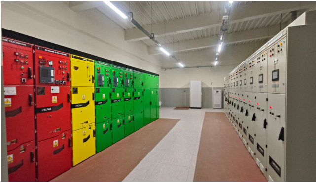
Rozdzielnice elektryczne średniego napięcia oraz prądu stałego w podstacji trakcyjnej tramwajowej.
